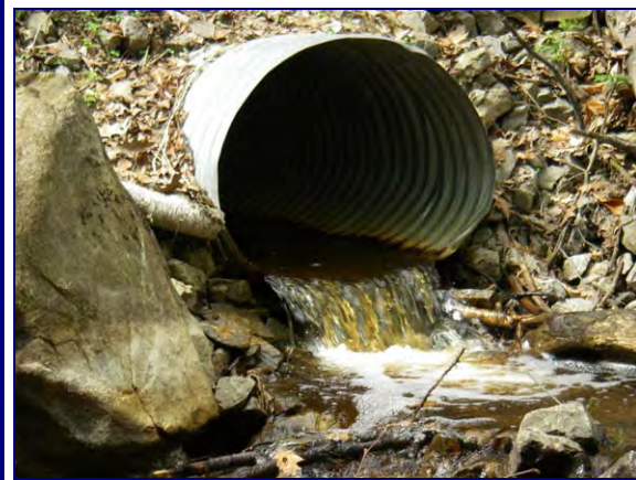
PHOTO 14 — Obstacle infranchissable causé par une mauvaise installation d'un ponceau (tronçon T 10)
